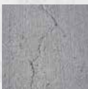
dringt in feinste Risse ein
