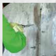
bildet Harz in trockenen Rissen
