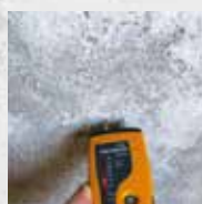
bei salzbelastetem Mauerwerk
