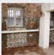
bei feuchtem Mauerwerk
