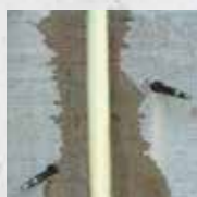
bildet Schaum in feuchten Rissen
